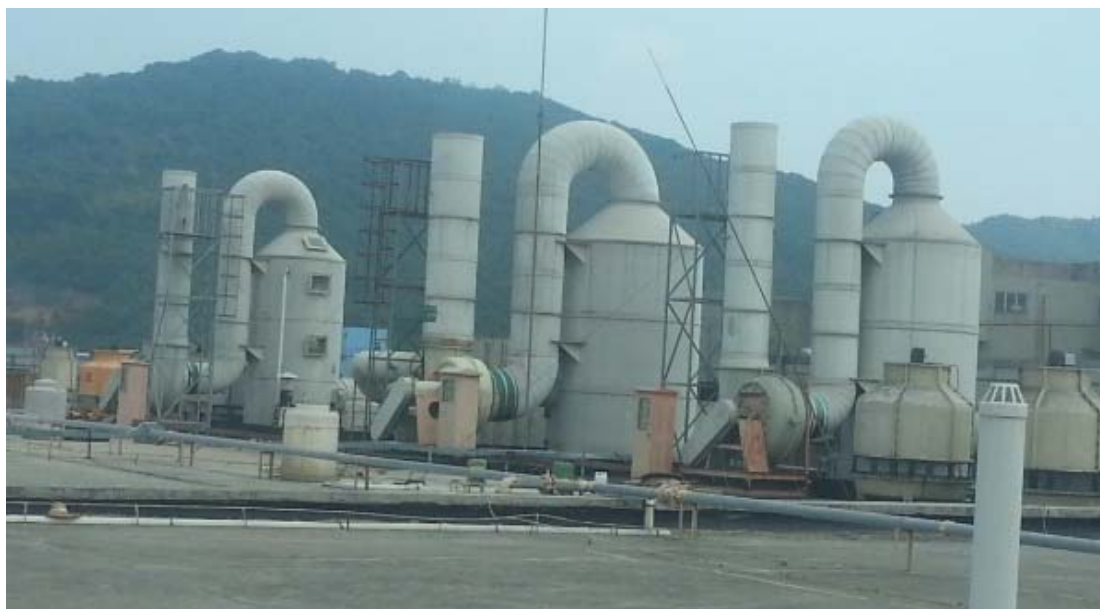
废气净化洗涤塔 ↑
